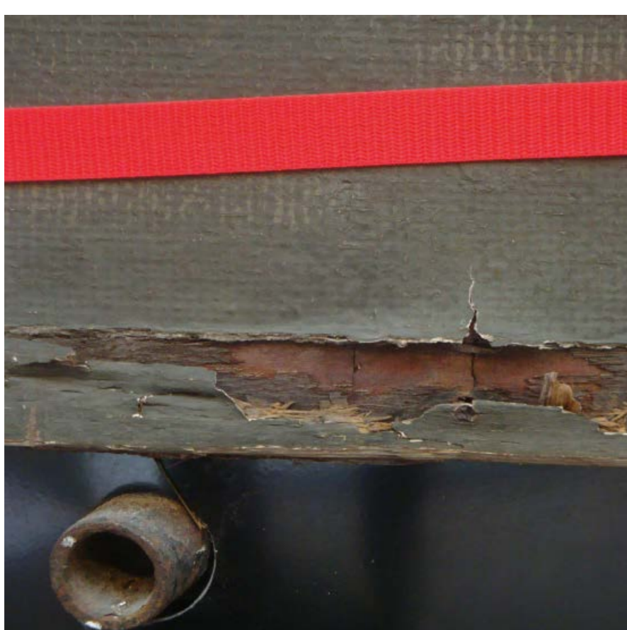
▲ Große Ausbruchstelle in der unteren Sockelkante
